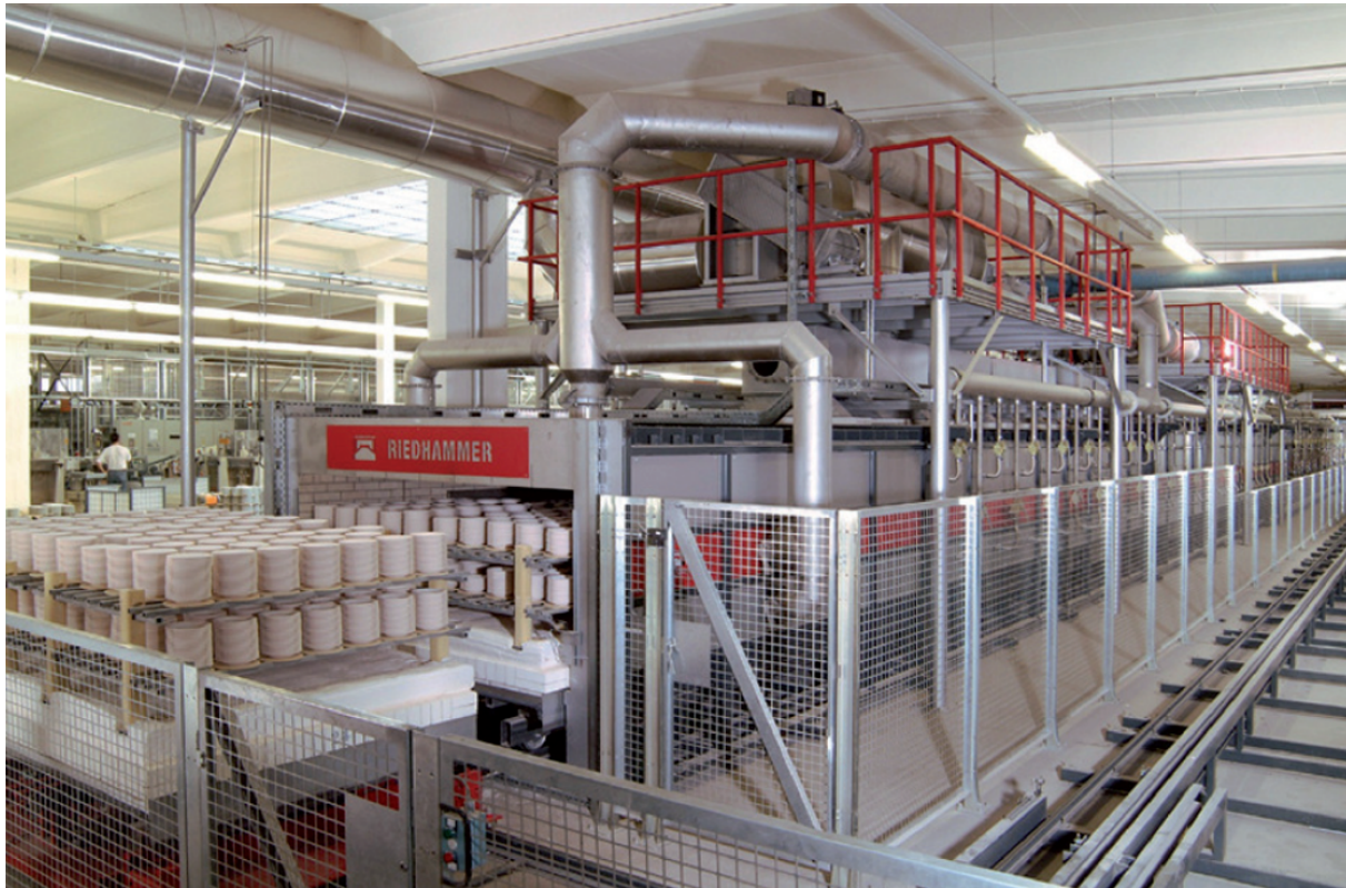
Abbildung 109: Foto eines Tunnelofens für das kontinuierliche Brennen von Dachziegeln
