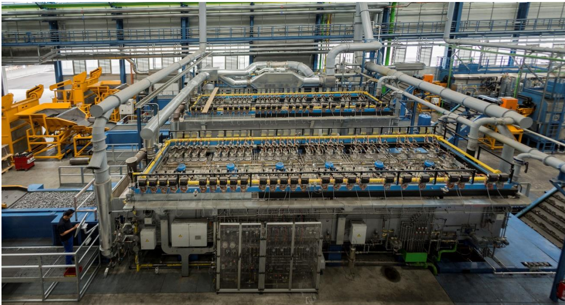
Abbildung 79: Bandofenlinie mit zwei Bandanlagen zum Wärmebehandeln von Schüttgütern
